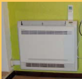
Pompe à chaleur
