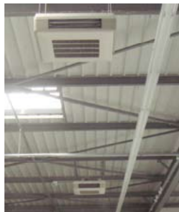
Pompe à chaleur pour surface de vente
